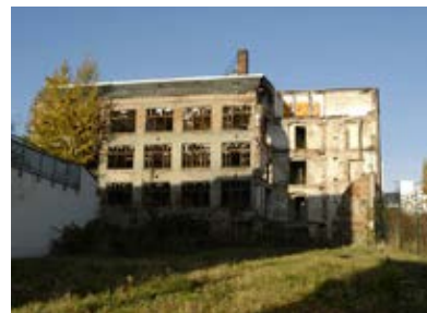
Das Hintergebäude musste 2007 nach Einsturz einer Giebelwand total abgebrochen werden.
